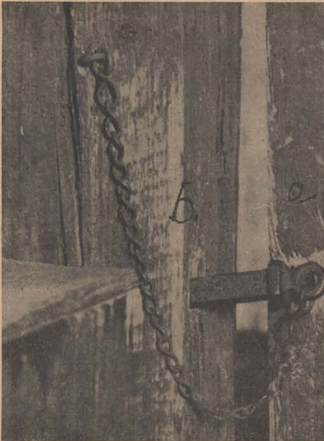
Az elhasználódás következtében a raktárajtó (a) és a raktárfalak (b) között támadt rés az elhatároló ütközővel.
